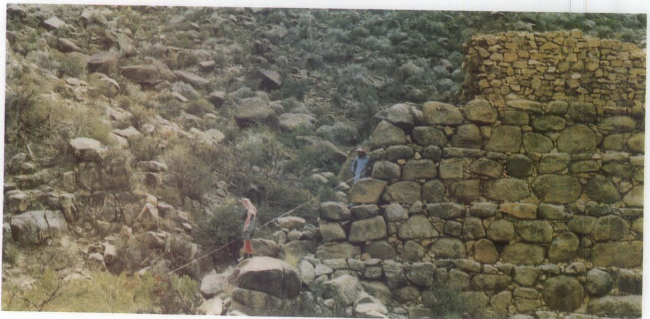
ج : جزء متصدع : درج في المجرى الجانبي وتشبيد جديد في الجانب العلوي C. Breached part; steps at downstream side and a new construction on upper side.
