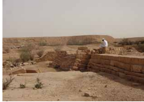
أ. سد مائي قديم يعاد ترميمه، شعيب قرى عبيد. a. An old water dam is being renovated, Qura Obaid valley.
